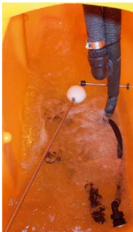
UF-Tank von innen: Beide Injektorleitungen reichen bis in den Sumpf.
